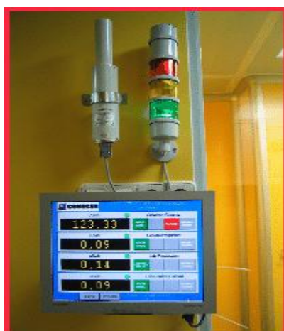
Fig. 4.6 – Monitor fixo de radiação e indicação luminosa do estado do acelerador.
