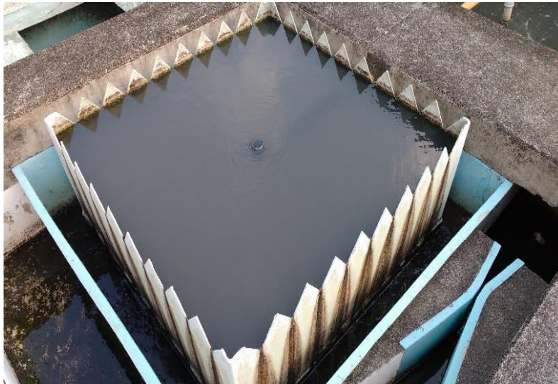
Figura 3.4 – Calhas vertedora para decantação primária para o processo de remoção de sólidos em suspensão e flutuantes.
