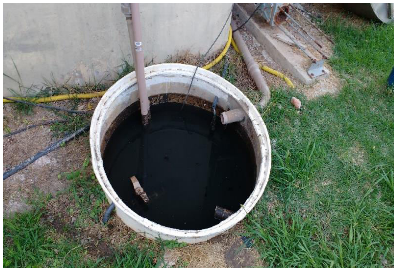
Figura 3.3 – Tanque de polietileno contendo esgoto.
