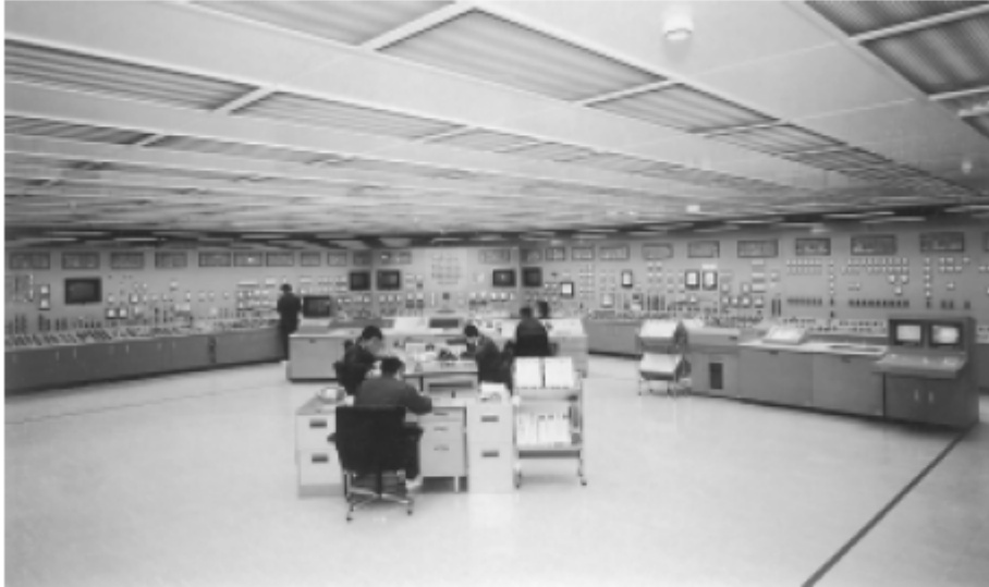
Figura 1.1 - Sala de Controle Convencional (IAEA, 1999)
