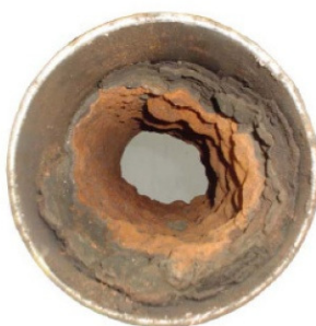
Figura I.1: Depósito de incrustação dentro de um duto de escoamento de petróleo (GARCIA, 2010).
