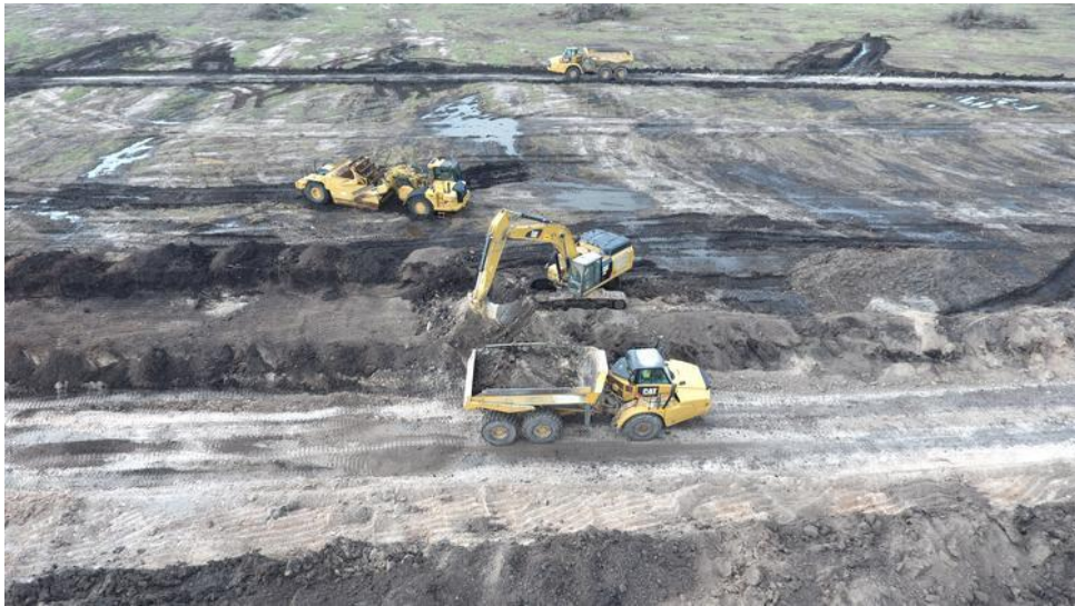
Figura 5.21 - Veículo para descarregamento dos rejeitos tratados no aterro (THE BUSINESS JOURNAL, 2022).
